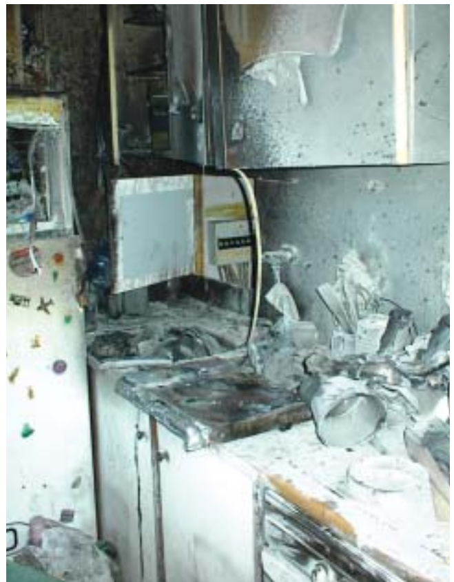
Neben der Gefahr für Leib und Leben verursachen Wohnungsbrände immer auch erhebliche Sachschäden.
