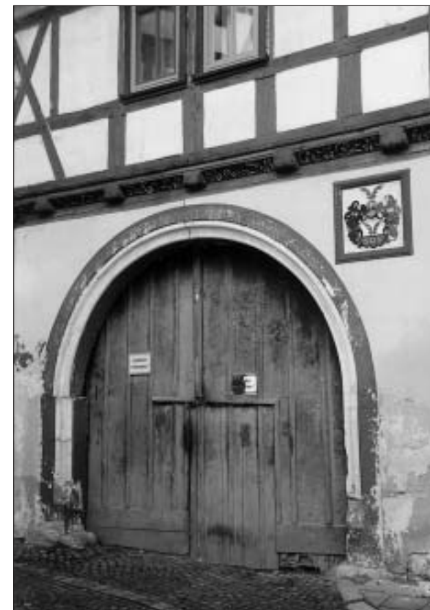
UNSER BILD: Im äußeren Bereich der Innenstadt gelegen, verspricht auch das Gebäude Schmiedhof Nr. 19 a – das „Stengelsche Haus“ – ein höchst attraktiver Blickfang zu werden. Im Innern schon vollständig modernisiert, werden die Handwerker erneut bestellt, wenn die beantragten Fördergelder zur Sanierung der Außenfassade genehmigt sind.
